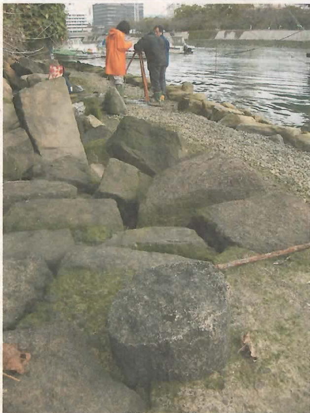
本川橋西詰めに残る崩れた石積み護岸。船をつないだ石柱(手前)は上部が欠けている —中区堺町の本川で
